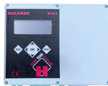
Schaltschrank mit einer Halsang H104 Steuerung und Frequenzmodulatoren
