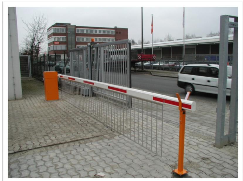
Zufahrt auch hier wieder in Verbindung mit einer Freitragenden Schiebtoranlage
